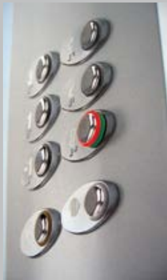
✓ Repères tactiles sur boutons d'ascenseurs
