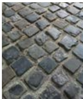
✗ Pavés bombés avec joints creux
