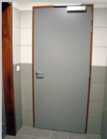
❌ Distance latérale insuffisante du côté de la poignée de porte
