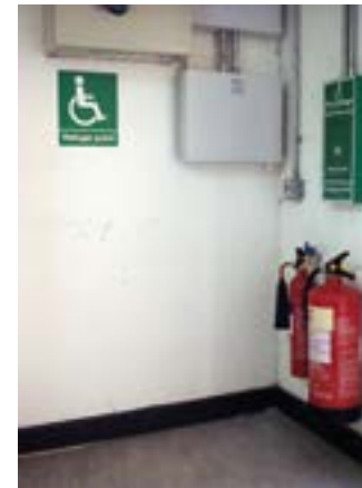
✓ Extincteur placé à bonne hauteur
